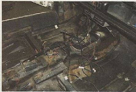
Ganz erstaunlich: Bodenbleche und Schweller waren kerngesund erhalten
