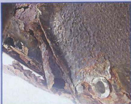
Das schlimmste an derartigen Rostorgien ist, dass es keinerlei Reparatur-Blechteile mehr...
